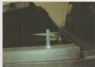
埋込式ネジ固定金具(カールプラグ)の状況
